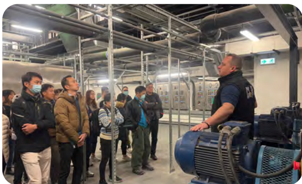
游泳池机房操作员证书课程的学员参观东昌街游泳池的机房。该机房是全港其中一个最先进的游泳池机房。
